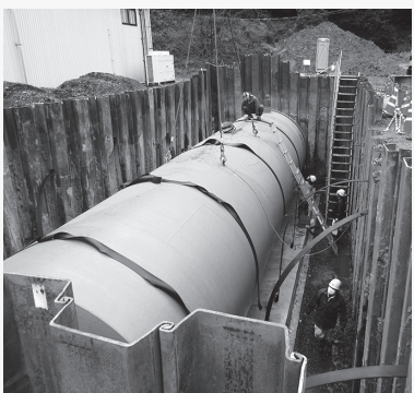
設置された大容量の防火水槽
